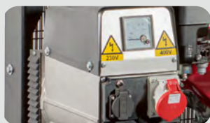
Generador: Trifásico con una base trifásica y una monofásica con disyuntor
